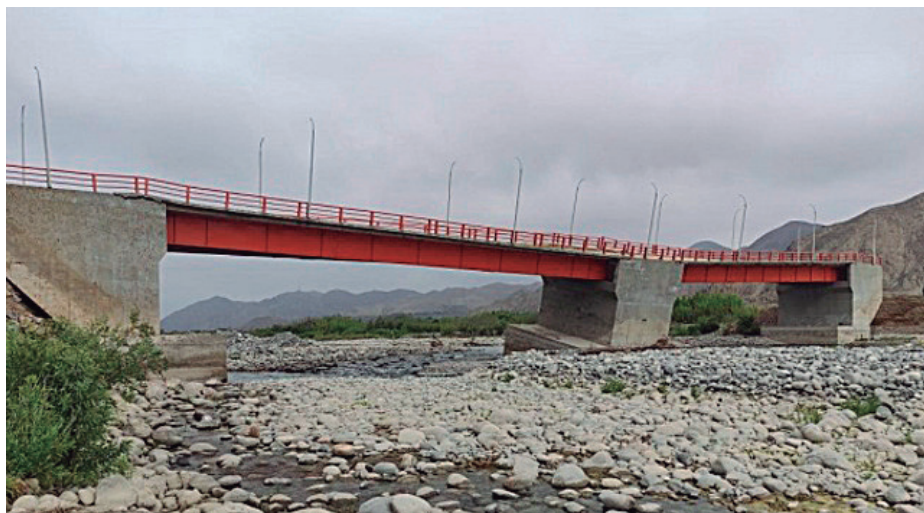
Puente Concón costó más de S/ 5 millones está inutilizable y a punto de colapsar en Lunahuaná.
